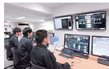
防災センター
